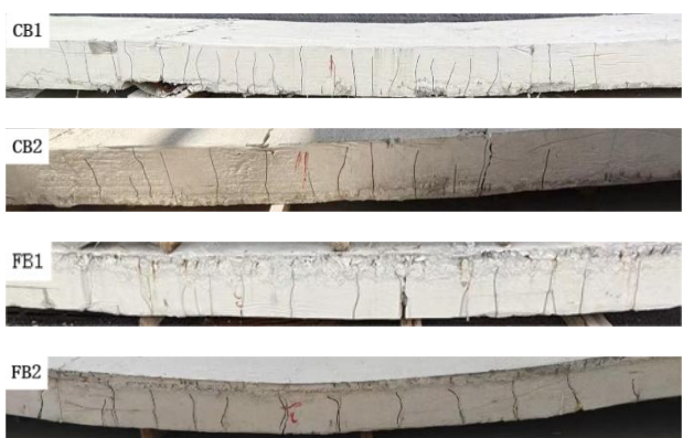
图 11 板侧裂缝分布图 Fig. 11 Distribution map of cracks on the plate side
